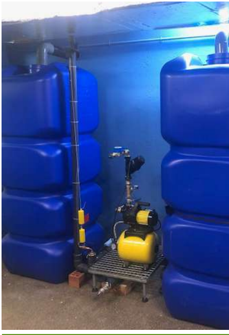
📌 Imagen 11: instalación de recuperación y transvase de aguas de depuración de piscina en Colegio Brains.
